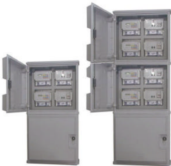
Quadro stradale a 2 scomparti
