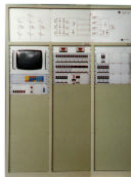
QUADRO DI CONTROLLO
