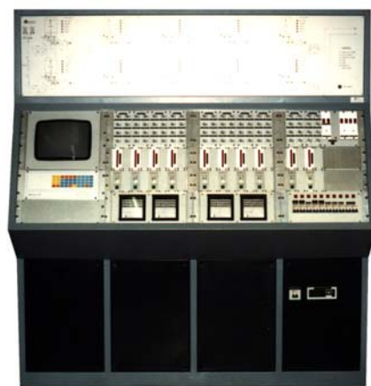
QUADRO DI CONTROLLO FILTRAZIONE A CARBONE POTABILIZZATORE DI RO (FERRARA-ITALIA) CONTROL BOARD FOR THE COAL WATER FILTERING PLANT RO WATER TREATMENT PLANT (FERRARA-ITALY)
