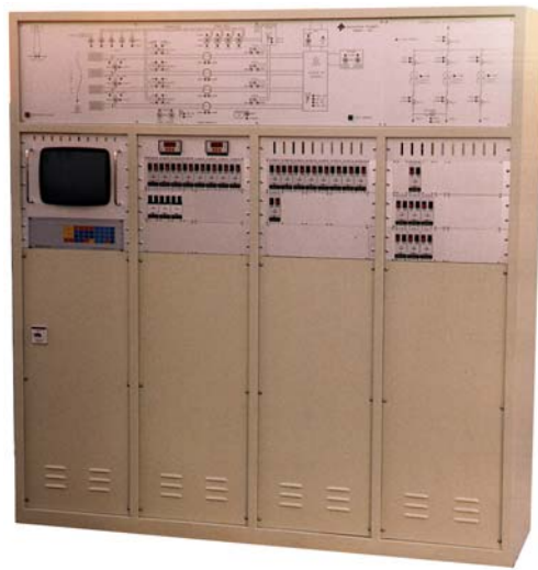
QUADRO DI CONTROLLO IMPIANTO DI SOLLEVAMENTO SUL FIUME PO CASAL MAGGIORE (MANTOVA-ITALIA) CONTROL BOARD FOR THE WATER PUMPAGE PLANT ON PO RIVER CASAL MAGGIORE (MANTOVA-ITALY)
