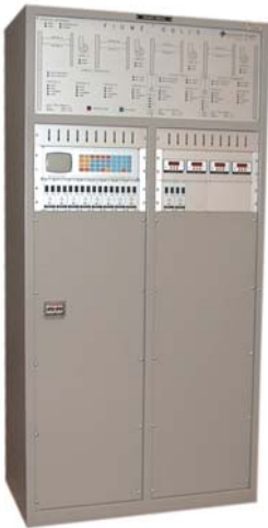
QUADRO DI CONTROLLO IMPIANTO DI SOLLEVAMENTO SUL FIUME OGLIO RONCOLE (MANTOVA-ITALIA) CONTROL BOARD FOR THE WATER PUMPAGE PLANT ON OGLIO RIVER RONCOLE (MANTOVA-ITALY)
