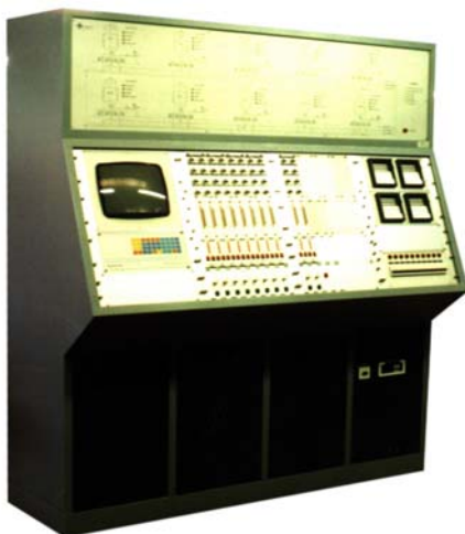
QUADRO DI CONTROLLO FILTRAZIONE A SABBIA POTABILIZZATORE DI RO (FERRARA-ITALIA) CONTROL BOARD FOR THE SAND WATER FILTERING PLANT RO WATER TREATMENT PLANT (FERRARA-ITALY)
