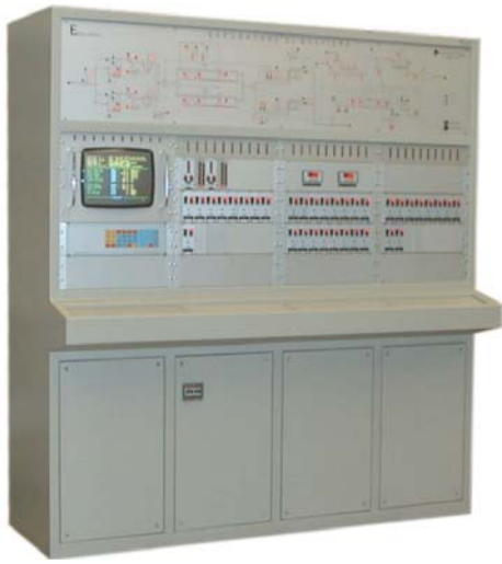
QUADRO DI CONTROLLO PER DEPURATORE CIVILE DI BOLTIERE (BERGAMO-ITALIA) CONTROL BOARD FOR THE PURIFICATION PLANTS OF BOLTIERE (BERGAMO-ITALY)
