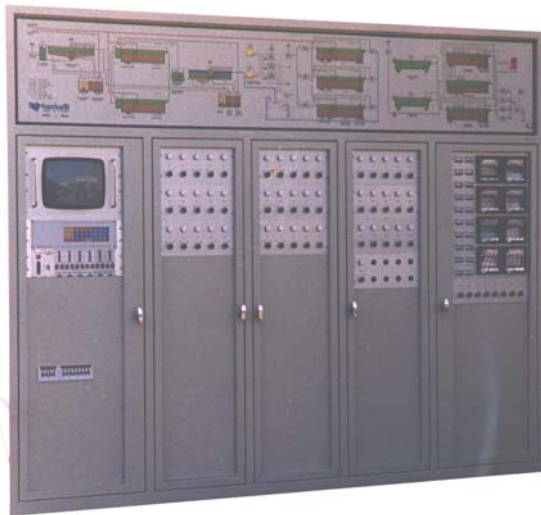
QUADRO DI CONTROLLO PER DEPURATORE CIVILE DI RICCIONE (RIMINI-ITALIA) CONTROL BOARD FOR THE CIVIL PURIFICATION PLANTS OF RICCIONE (RIMINI-ITALY)
